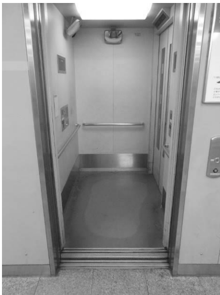
JR 三ノ宮駅 EV 入り口幅 90 センチ
