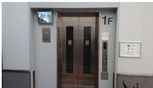
歩道橋エレベーター（通り抜け・15人乗り）
