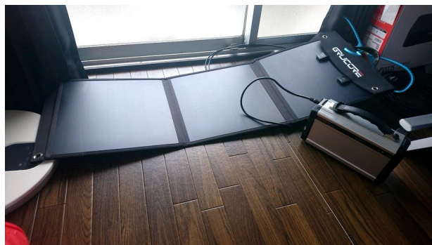
図14 太陽光パネルで蓄電池を充電中
